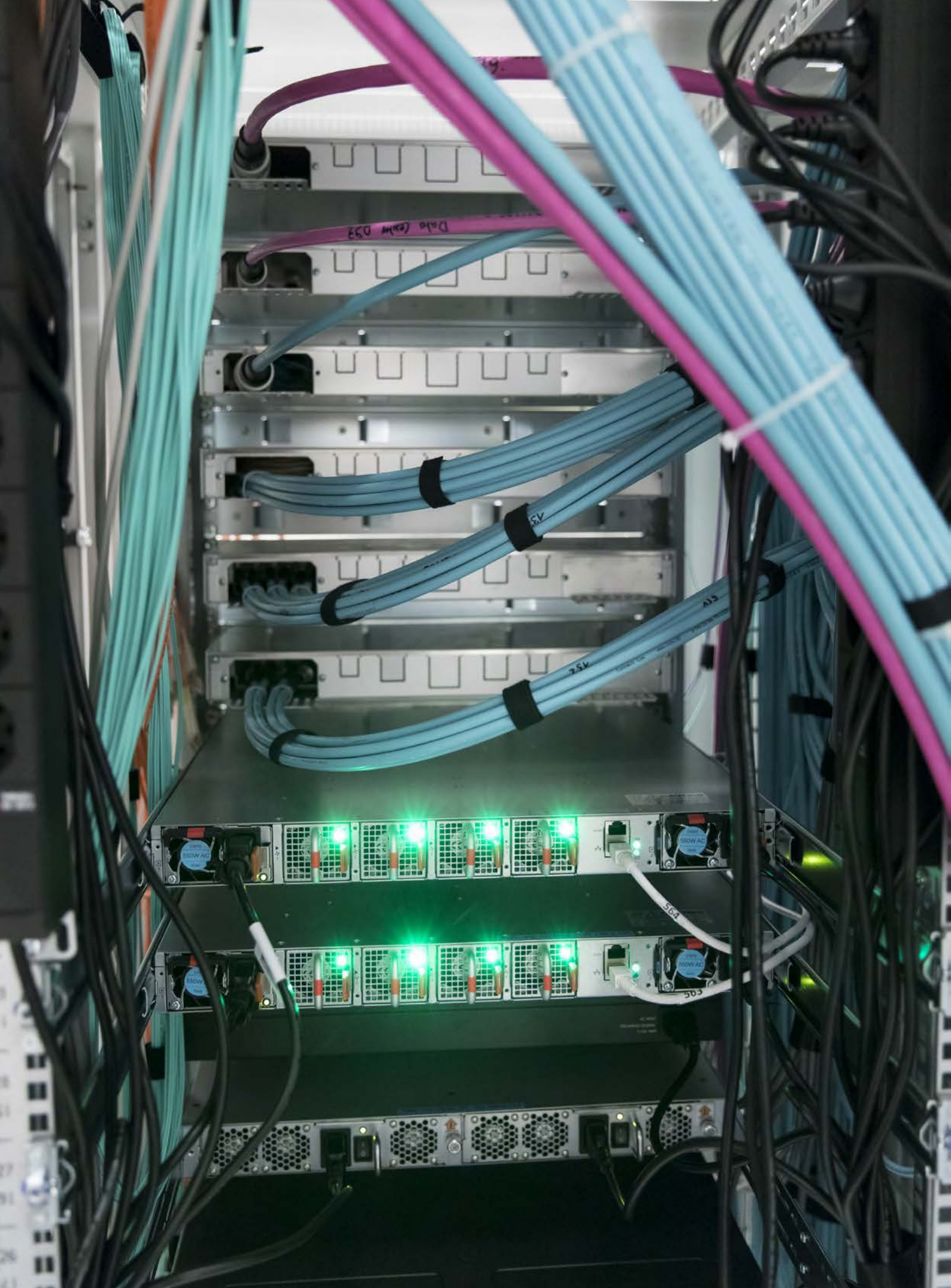
Ein komplexes und sicheres IT-Netzwerk ermöglicht den reibungslosen Betrieb der Anlagen.
