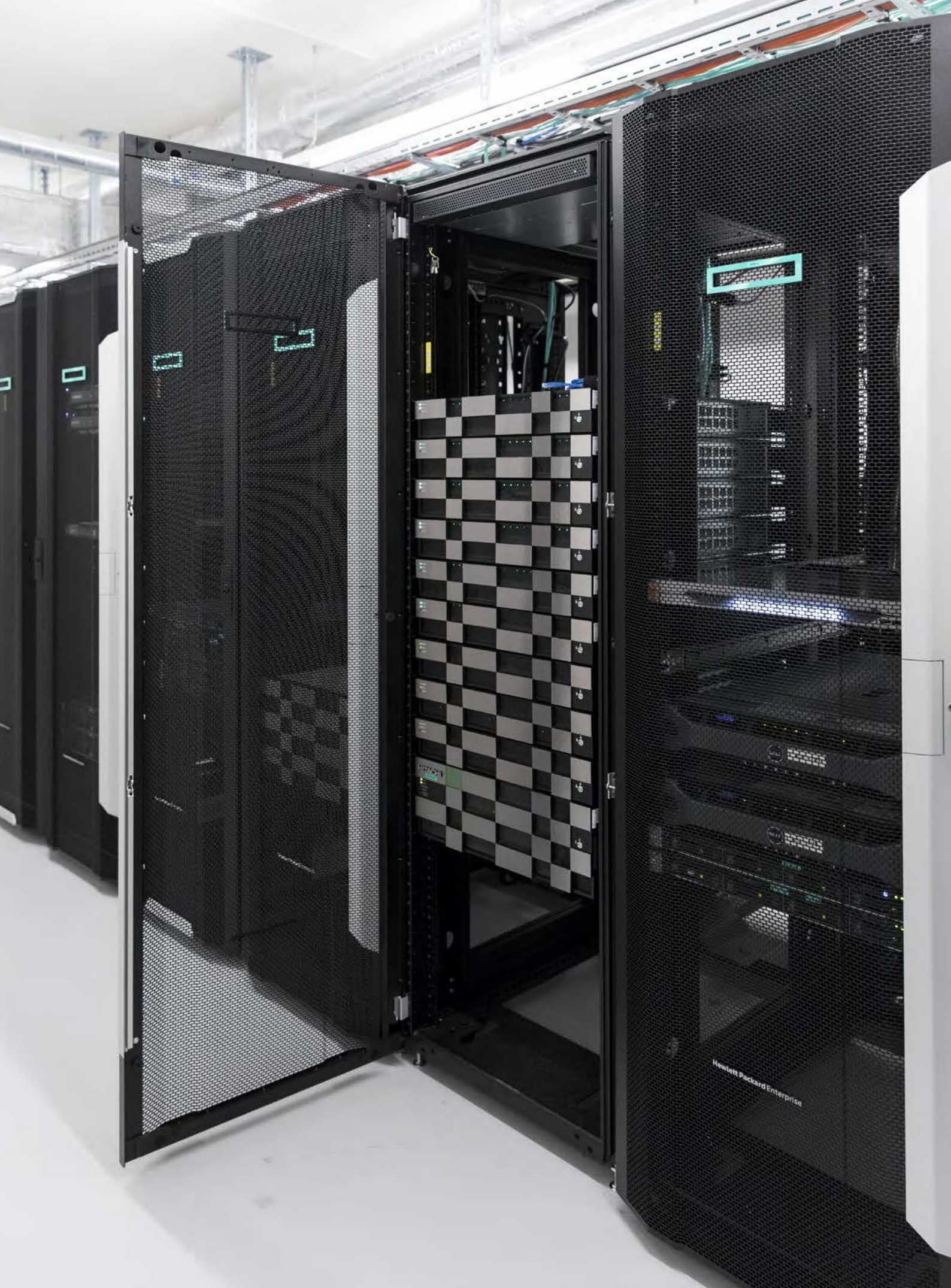
Serverschrank im Forschungs- und Archivierungszentrum in Penthaaz.
